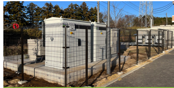
30kW/73.7kWh 自家消費、予備電源
