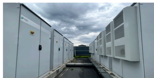
日本群馬養鰻場 PV + 蓄電池システム
