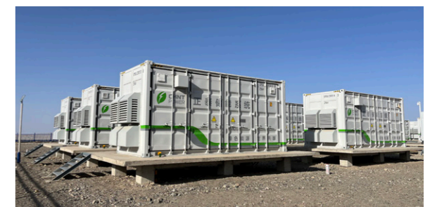
40MW/80MWh 蓄電池システム
