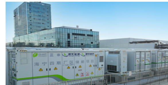
10MW/20MWh 工業・商業用蓄電プロジェクト
