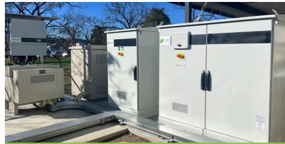
30kW/73.7kWh 自家消費、予備電源
