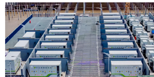
50MW/100MWh 液冷蓄電プロジェクト
